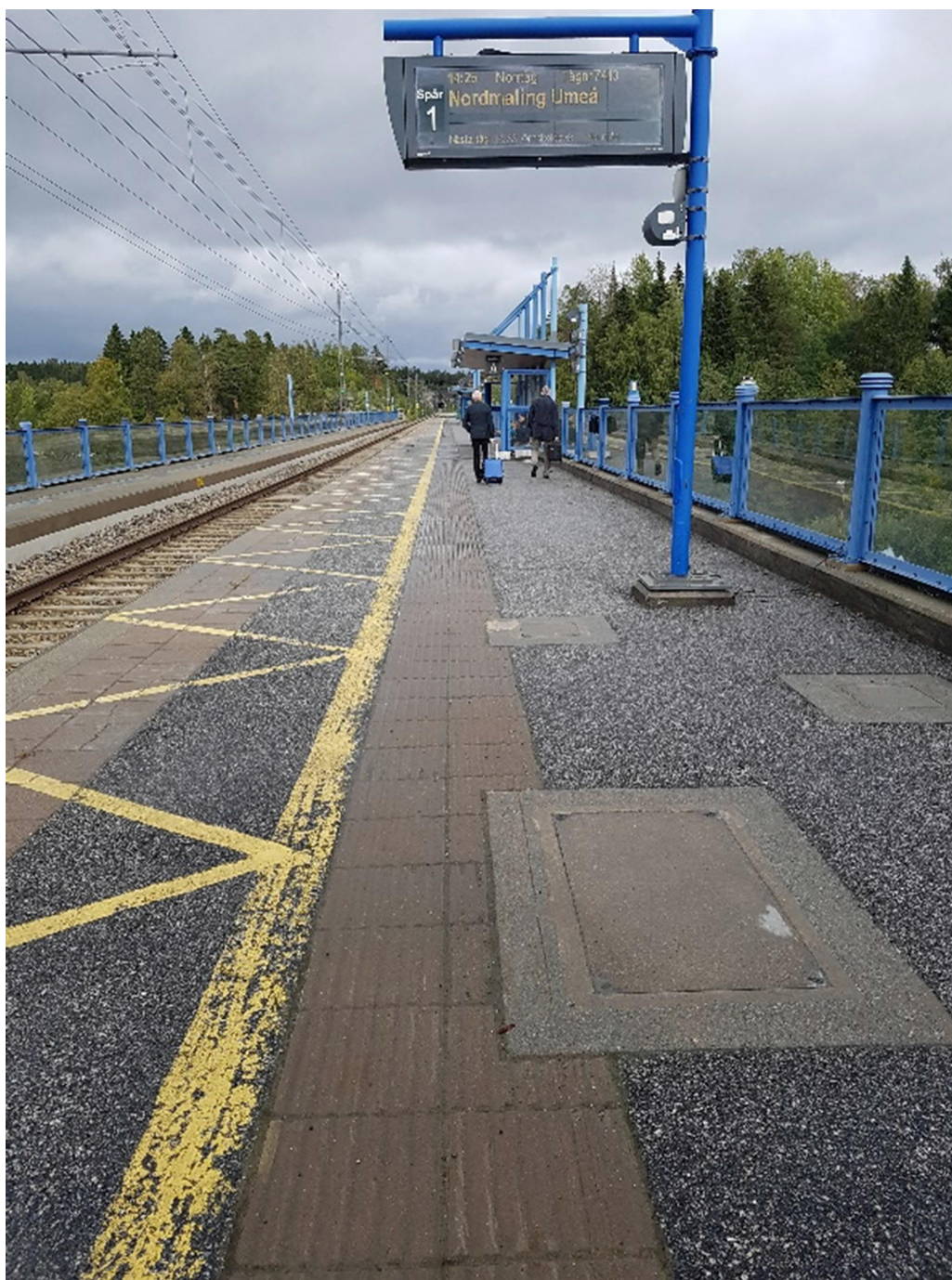
Bild 50. Bristfällig kontrastmarkering för ledyta och mot plattformskant.
