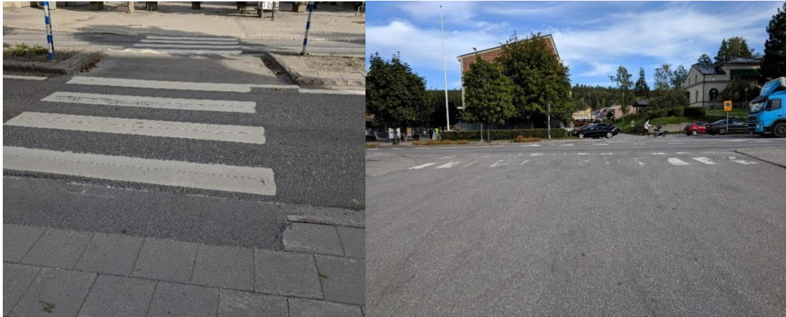
Bild 26. Övergångsställe utan kantsten (vänster) övergångsställe med dåliga markeringar (höger).
