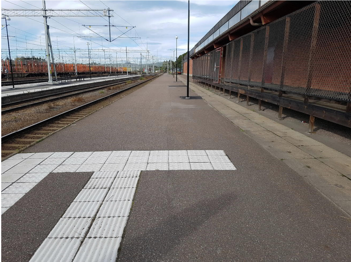
Bild 31. Kupolplattor på plattform.
